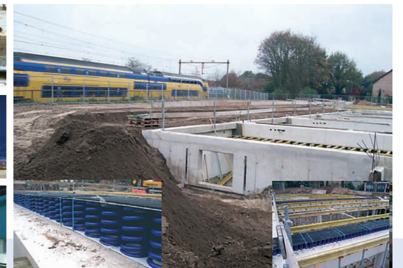
■ Trillingsdempers voor 36 woningen Residence Villa Mes-Wychen
