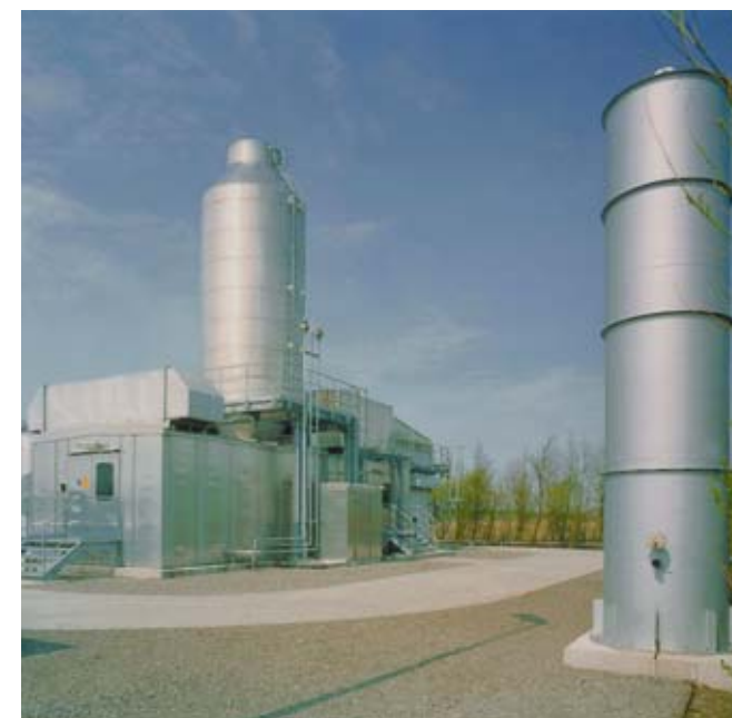
Schallschutzkapsel mit Ansaug-, Abgas- und Lüftungssystem; Solar Taurus, Gaskompressorstation, Emden, Deutschland
