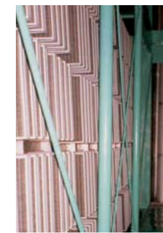
Filterhausplenum mit Feinfilter und Schalldämpferkulissen, Siemens, V94.2, Bratislava, Slowakische Republik
