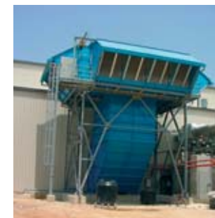
Ansaugsystem mit Filterhaus und Ansaugkanal, Siemens S64.3A, Gasturbinenkraftwerk, San Pedro de Macoris, Dominikanische Republik
