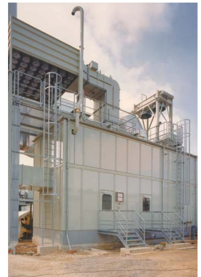
Schallschutzkapsel mit Ansaug-, Abgas- und Lüftungssystem; Solar Centaur, Gaskompressorstation, Amberg, Deutschland
