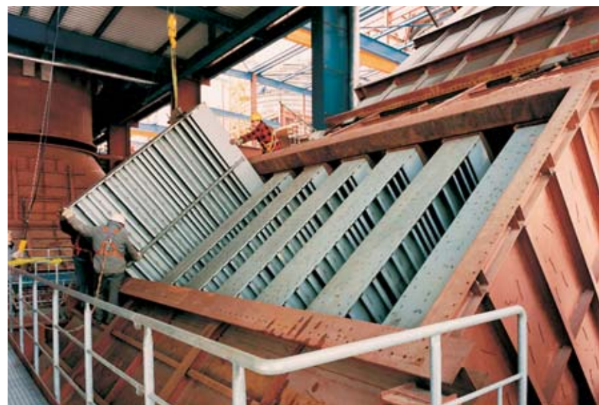
Braunkohlekraftwerk Jämschwalde bei Cottbus. Schlüsselfertige Erstellung des schalldämmten Kanalsystems und Einbau von 480 Schalldämpferkulissen in eine Rauchgas-Entschwefelungsanlage
