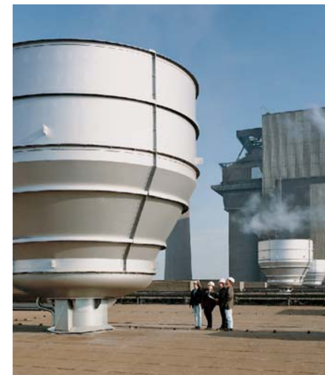
Dampf-Ausblaseschalldämpfer Kohlekraftwerk Niederaußem, Deutschland
