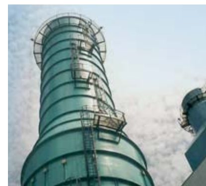
Bypasskamin mit Schalldämpfergehäuse für Gasturbinenkraftwerk, Siemens V94.2, Bratislava, Slowakische Republik
