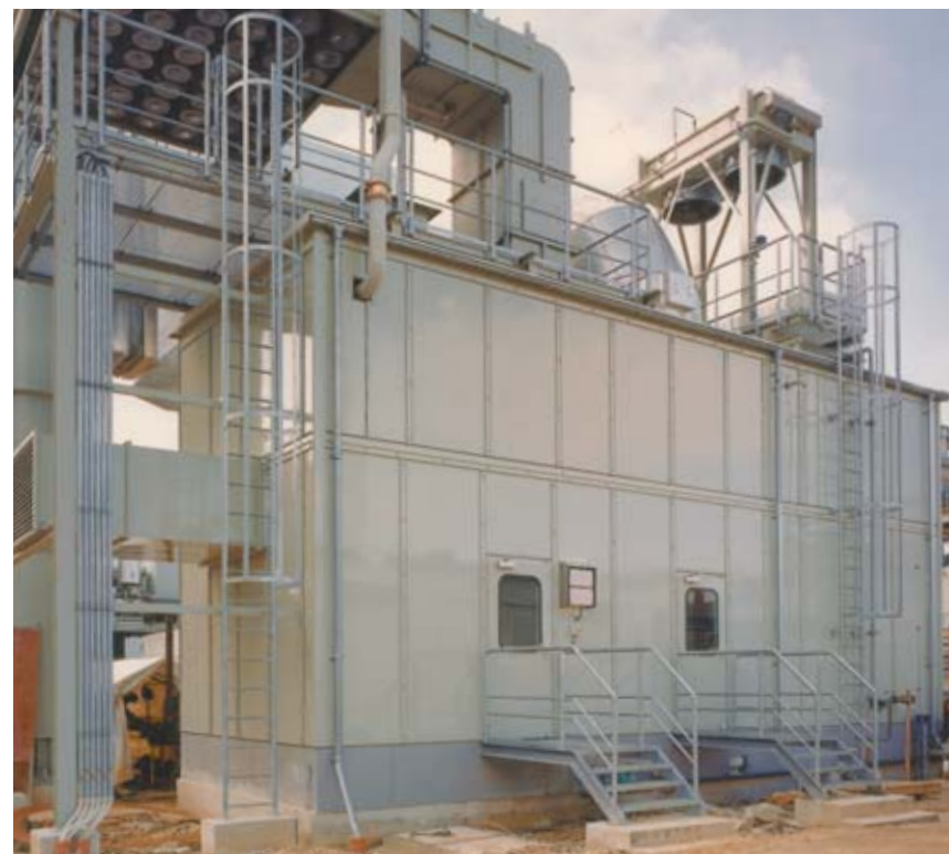
Schallschutzkapsel mit Ansaug-, Abgas- und Lüftungssystem; Solar Centaur, Gaskompressorstation, Amberg, Deutschland
