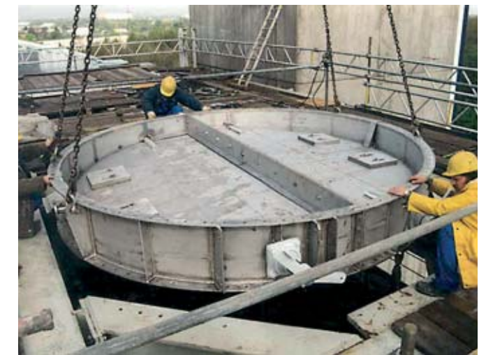
Kaminklappe, Durchmesser 4,5m, Alstom Abhitzeessel, Köln, Deutschland
